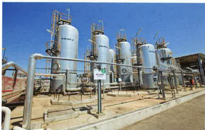
■ Décanteurs pour la préparation des slops sur le site de Sines (Portugal).
