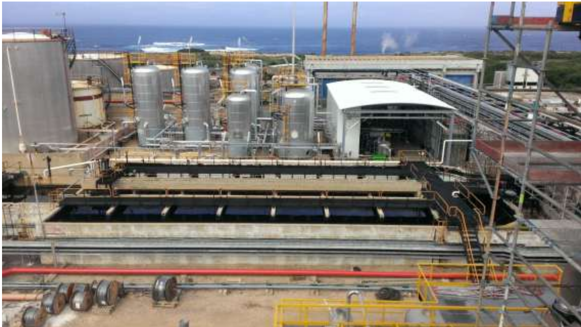
Vue d'ensemble de l'unité de séparation
